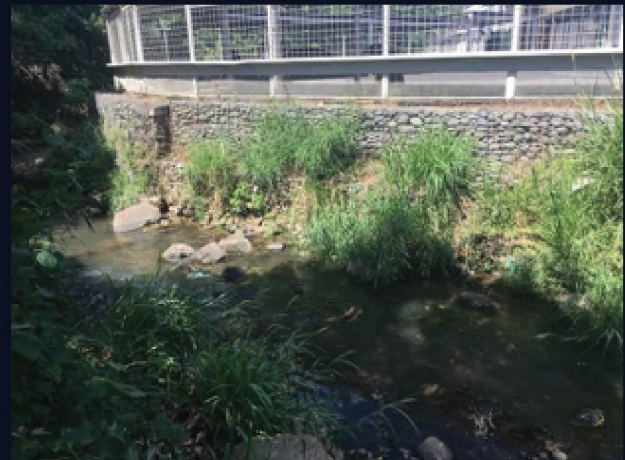
Utilización de gaviones en la ribera del río. Sitio 19; Cercano a la UACA.
