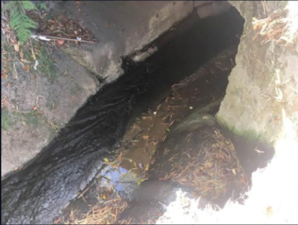
Descargas de aguas negras. Sitio 21. Cercanías Colegio San Lorenzo.
